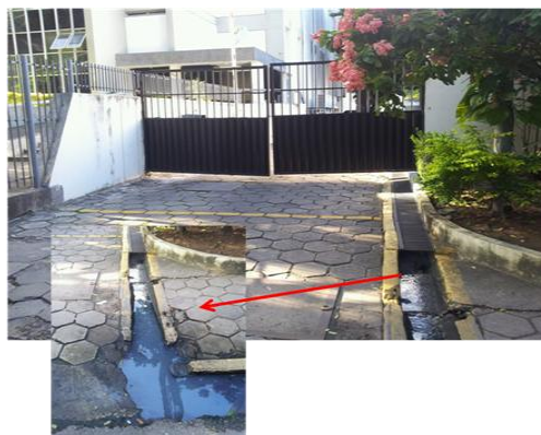
DRENAGEM DE PRÉDIO LIGADA AO ELEMENTO DE DRENAGEM DA VIA
