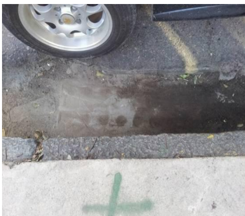
BOCA DE LOBO OBSTRUÍDA
